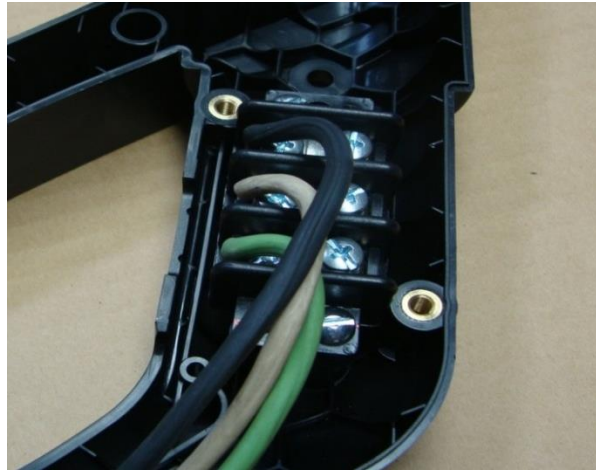
Fig.6-17 Cableado de la Caja de Terminales
