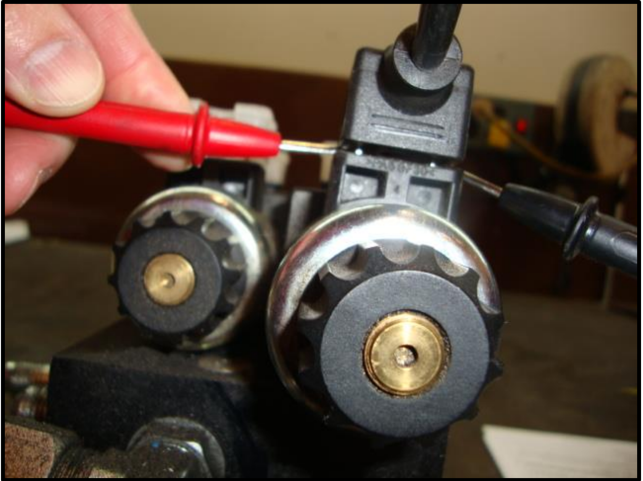
Fig. 8-5 Checking Din Plug Voltage
